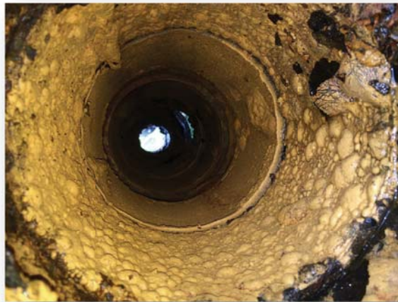
Altes, ausgebautes Rohr aus dem Rohrleitungssystem
